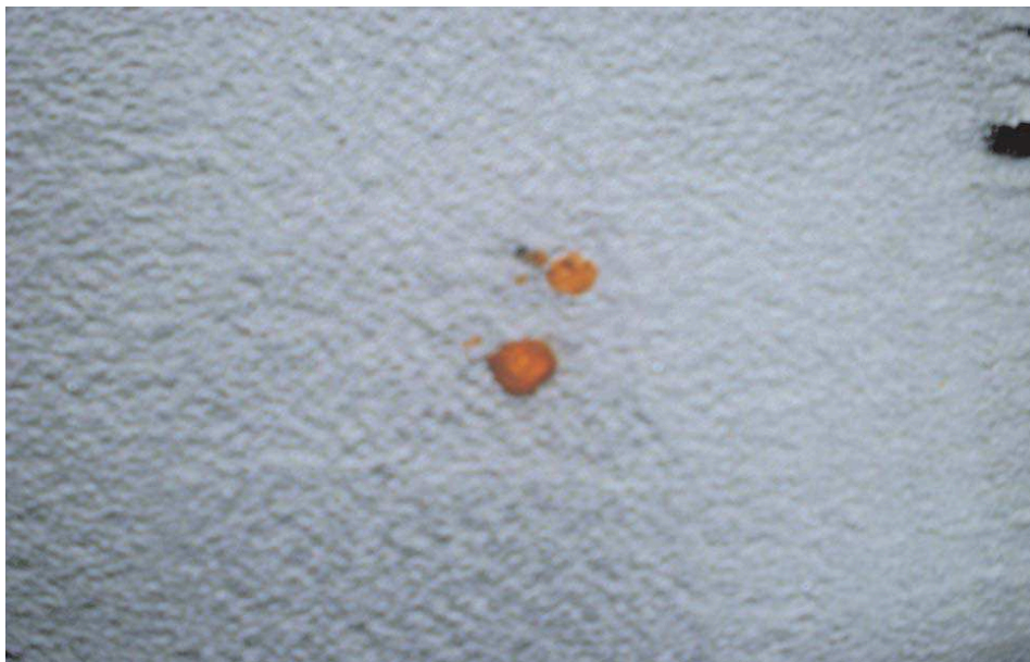
Ryc. 1. Fragment wyprawy klejowej z dodatkiem reduktora z widocznymi barwnymi plamami sporządzony w laboratorium ISCMOİB, na bazie cementu CEM I 32,5 R
