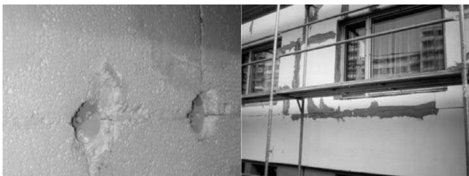
Rys. 4. Szpachlowanie połączeń płyt styropianowych, brak ocieplenia ościeży okiennych oraz uszkodzenie warstwy termoizolacyjnej przy zastosowaniu łączników (materiały szkoleniowe firmy Baunit)
