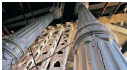
Fot. 8. Widok pękniętego żeliwnego słupa w wiadukcie nad ul. Zielińskiego we Wrocławiu
