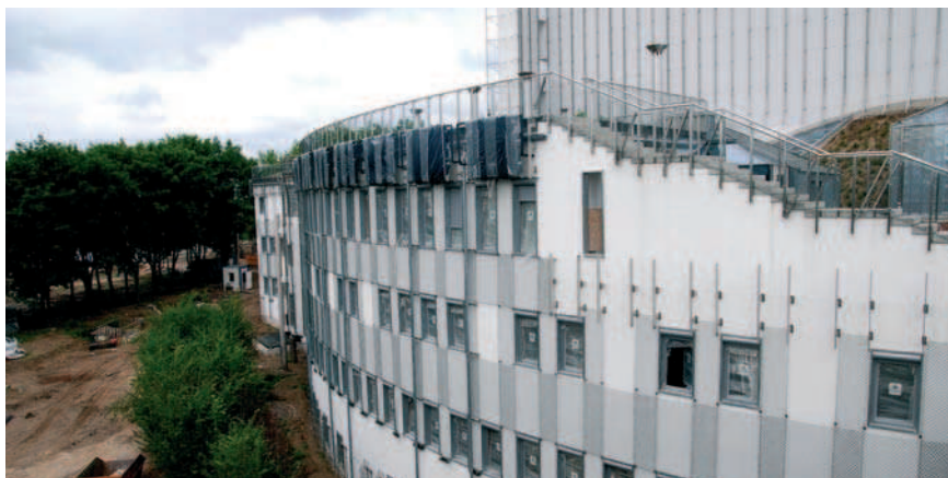
Fot. 2. Instalacje solarne umieszczone na elewacji południowej Opery Podlaskiej
