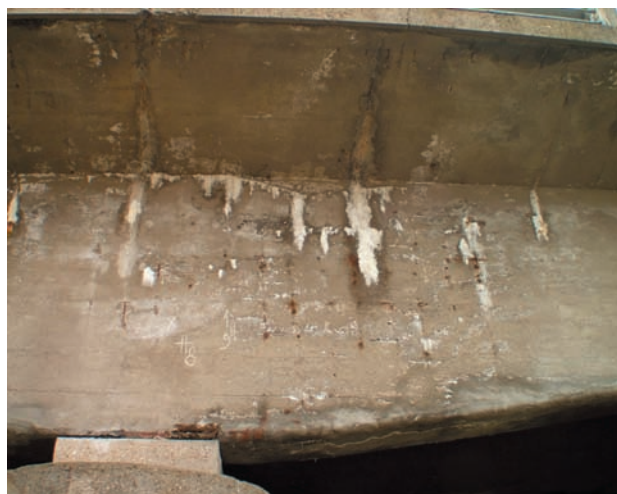
Fot. 1. Most przez Dunajec w miejscowości Zgłobice (zacieki i wykwyty na powierzchni bocznej belki skrajnej)
