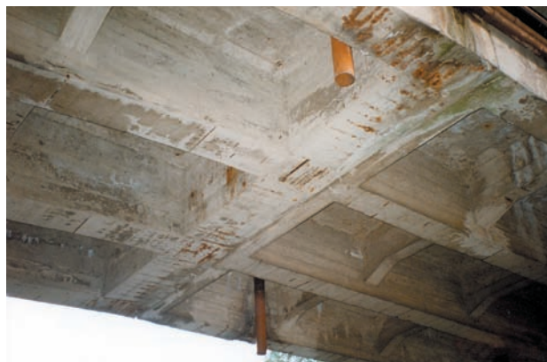
Fot. 2. Most przez Wkrę w miejscowości Pomiechówek (zbyt mała otulina, widoczne ogniska korozyjne i korozja strzemion)
