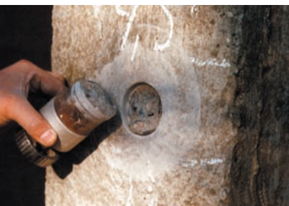
Fot. 6. Widok prawidłowego przełomu betonu w miejscu pomiaru jego wytrzymałości na odrywanie
