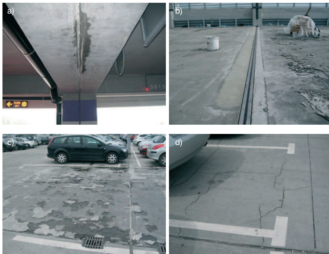
Rys. 3. a) Sączenie wody na styku zdwojonych rygli, b) Naprawa nieprawidłowo wykonanych szczegółów w strefie zainstalowania profilu dylatacyjnego, c) Powierzchniowe ubytki betonu, d) Niekontrolowane pęknięcia
