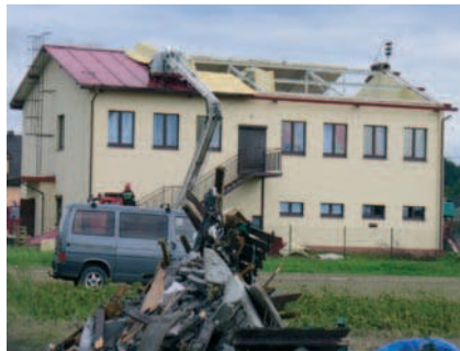
Rys. 11. Uszkodzony dach na budynku Ochotniczej Straży Pożarnej
