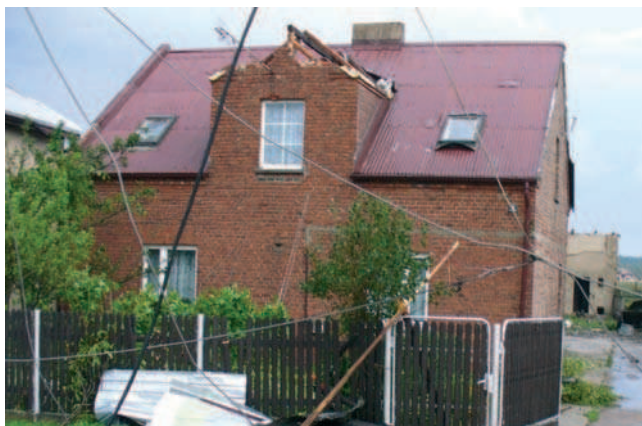
Rys. 6. Uszkodzenia dachu wielopłocaciowego
