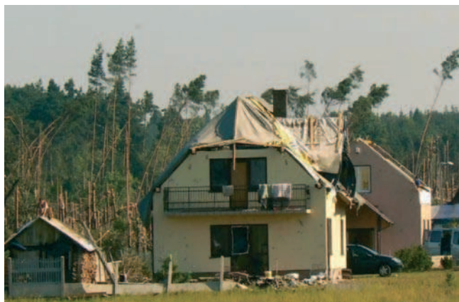
Rys. 5. Uszkodzenia dachów spadzistych zorientowanych szczytem do kierunku działania wiatru
