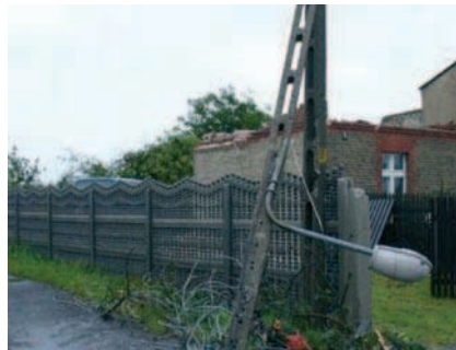
Rys. 12. Złamany słup linii elektrycznej
