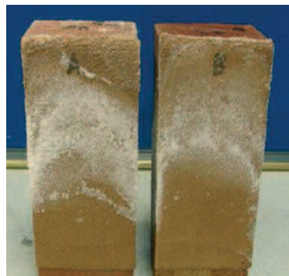
Rys. 5. Krystalizacja soli na powierzchni ściany ceglanej pokrytej warstwą gipsowego tynku [12]
