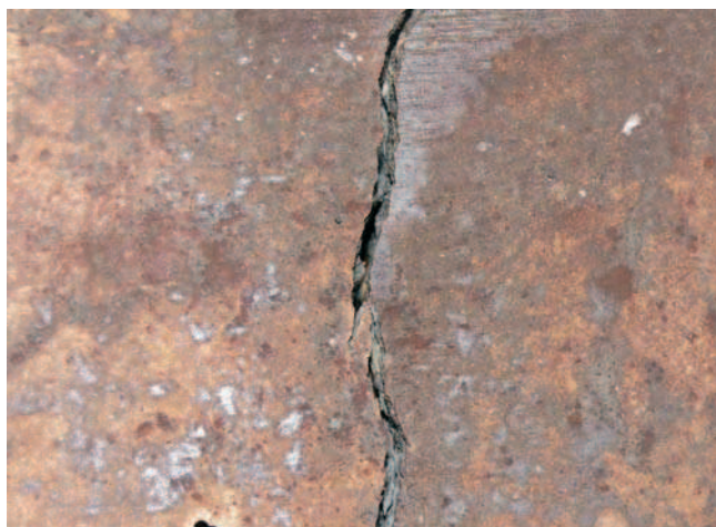
Rys. 1. Pęknięcie betonowej konstrukcji kolektora kanalizacyjnego [2]
