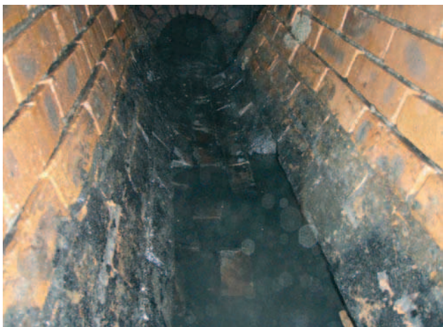
Rys. 9. Zapadnięcie się dna kolektora kanalizacyjnego [2]
