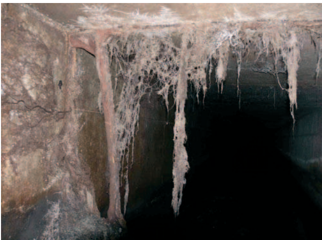
Rys. 5. Przerost korzeni drzew przez nieszczelną dylatację konstrukcji kolektora [2]
