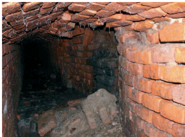
Rys. 8. Wypadanie cegieł ze stropu i ścian konstrukcji kolektora [2]
