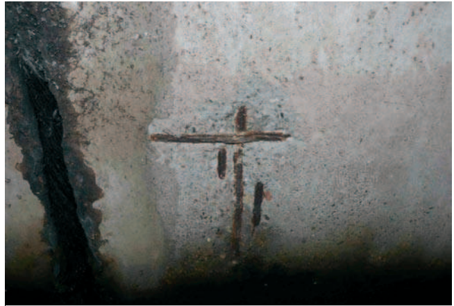
Rys. 4. Odkryte zbrojenie konstrukcji żelbetowej kolektora kanalizacyjnego [2]
