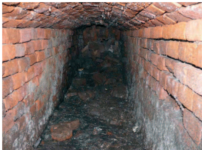
Rys. 10. Zniszczona konstrukcja kolektora kanalizacyjnego [2]
