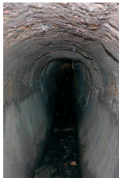
Rys. 2. Korozja żelbetowej konstrukcji kolektora kanalizacyjnego [2]
