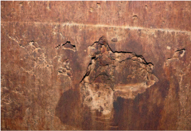
Rys. 3. Raki w konstrukcji ściany kolektora kanalizacyjnego [2]
