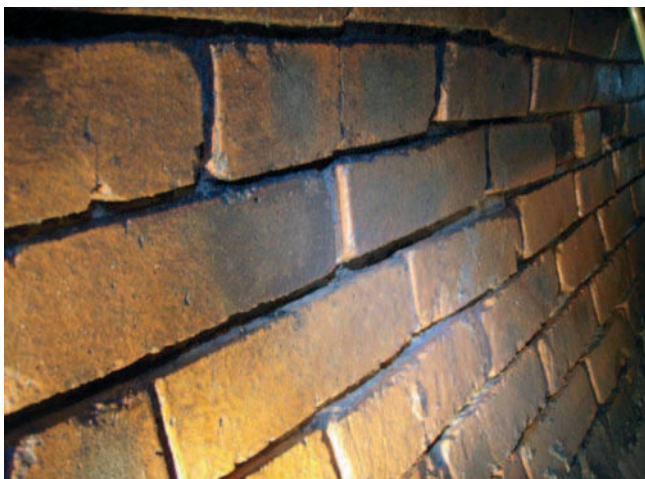
Rys. 7. Wykruszenie i wytlukanie spoin spomiędzy cegieł [2]
