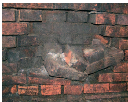
Rys. 12. Luźne elementy konstrukcji murowanej [3]
