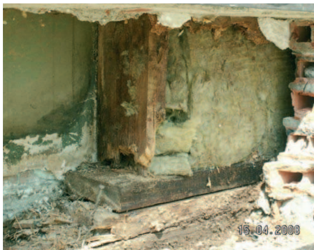
Rys. 4. Uszkodzenia podwaliny i słupków konstrukcji ścian
