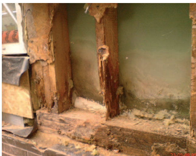
Rys. 5. Uszkodzenia słupków, na których oparto wiązary dachowe
