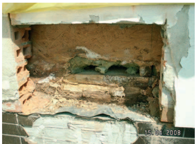
Rys. 3. Uszkodzenia podwaliny i poszycia zewnętrznego ścian
