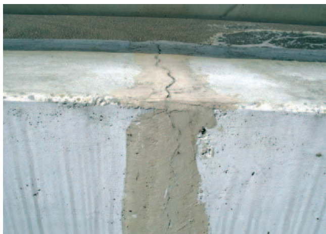
Rys. 3. Pęknięcie w części górnej ściany podłużnej
