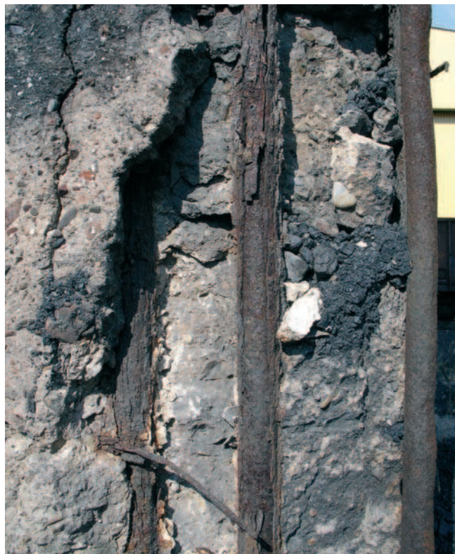
Rys. 6. Silna korozja zbrojenia w słupie w składzie węgla (m.in. zniszczone strzemiona)
