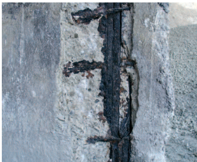
Rys. 5. Uszkodzenia słupa w składzie gipsu – widoczne pęknięcia i odsłonięcie otuliny, silna korozja zbrojenia
