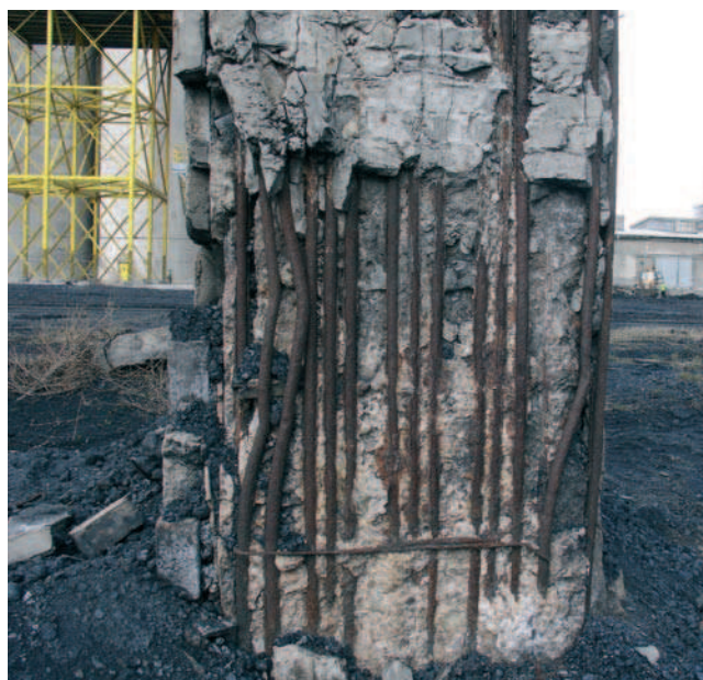
Rys. 3. Rozległe uszkodzenia betonu oraz prętów zbrojenia słupa w składzie węgla – widoczne połączenia prętów na zakład
