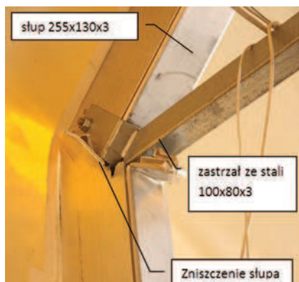
Rys. 2. Zniszczony słup poprzecznej ramy nośnej hali w przekroju największego momentu zginającego
