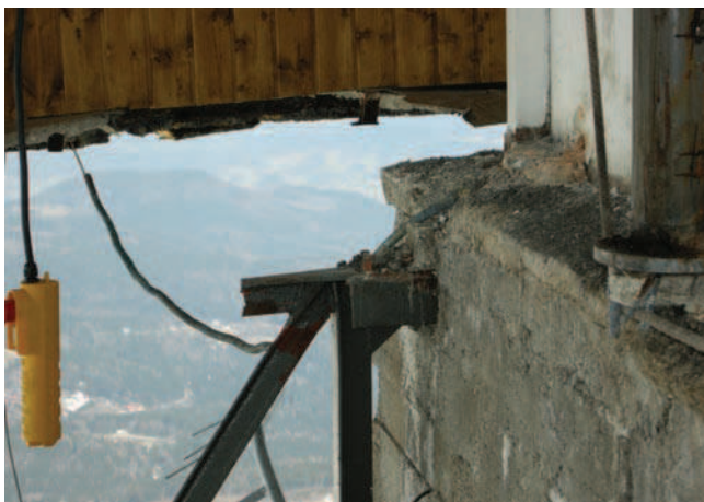
Rys. 4. Widoczne zerwanie pasa górnego kraty wspornikowej w miejscu wykonania spoiny
