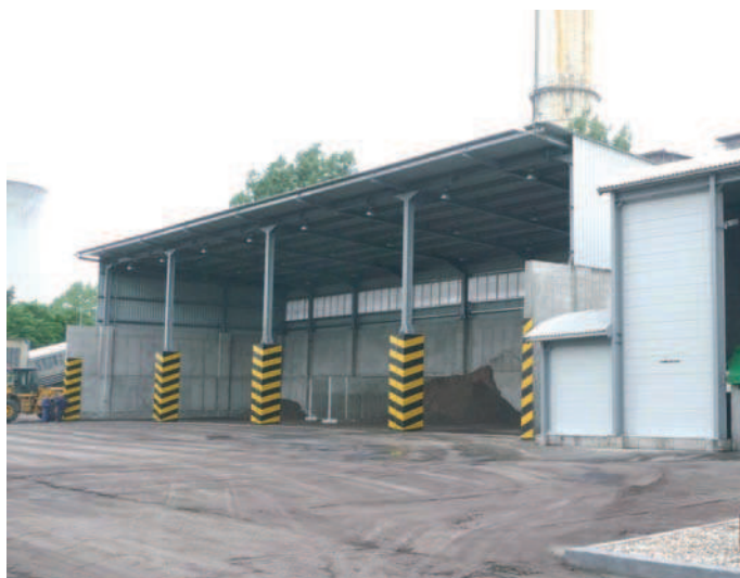
Fot. 2. Wiatła stalowa jako powszechnie stosowany magazyn biomasy
