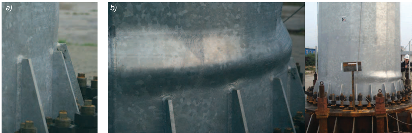
Fot. 1. Model zniszczenia słupa rurowego: a) praca w stanie nadkrytycznym, b) utrata stateczności lokalnej w strefie ściskanej płaszczka słupa
