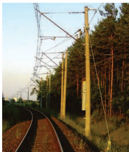
Rys. 8. Wirowane słupy trakcyjne typu ETG (kotwowy, krzyżowy, przelotowy) na torze doświadczalnym w Węglewie koło Żmigrodu
