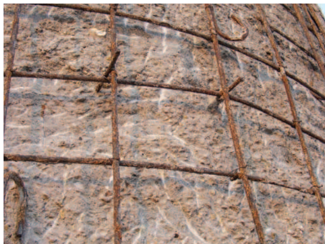
Rys. 2. Odstonione zbrojenie po usunięciu skorodowanej partii betonu z zewnętrznej powierzchni trzonu żelbetowego
