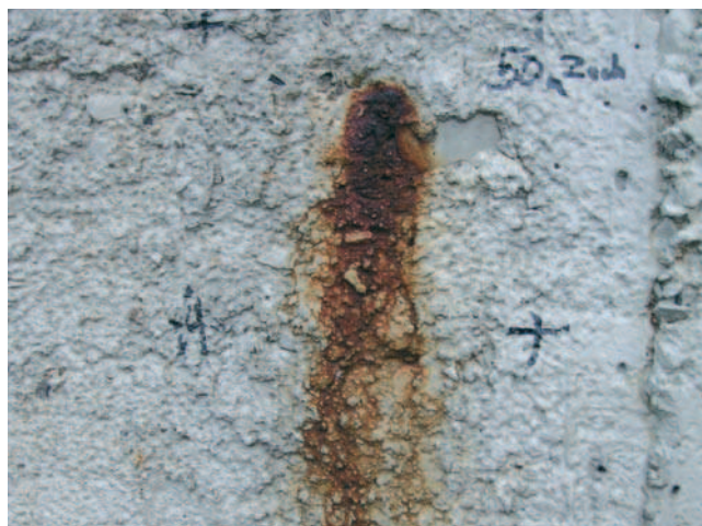
Rys. 2. Przykład wycieków produktów korozji stali zbrojeniowej
