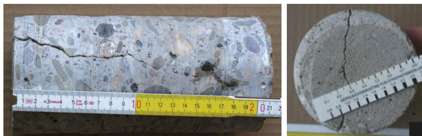
Rys. 3. Rysa zewnętrzna, strefa ściskana
