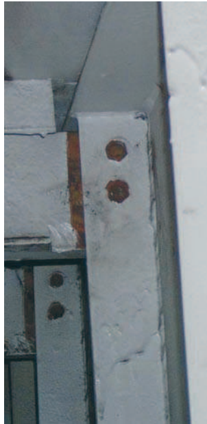
Rys. 5b. Widok uszkodzonego połączenia belki po ścięciu 2 śrub M16
