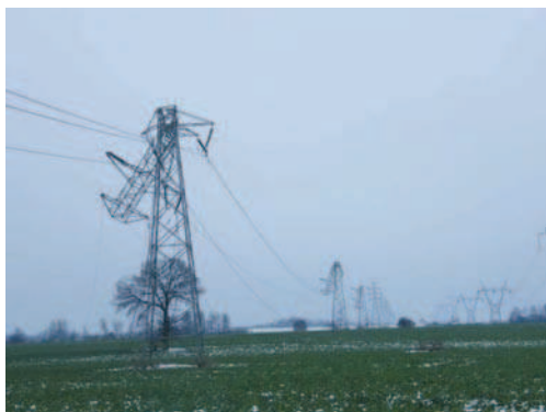
Rys. 1. Kaskadowe zniszczenie słupów przelotowych linii 110 kV Morzyczyn – Łobez (słupy 75–73) o wysokiej regularności formy zniszczenia. Widok w kierunku Morzyczyna. W głębi począwszy od słupa 72 brak uszkodzeń. Z prawej strony linia 400 kV Krajnik – Dunowo bez uszkodzeń
