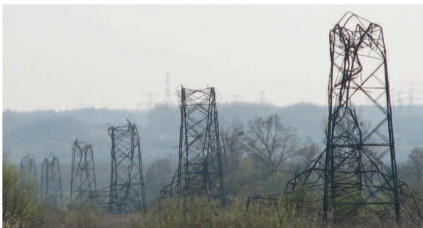
Rys. 2. Kaskadowe zniszczenie słupów przelotowych 124÷129 na linii 220 kV Morzyczyn – Police
