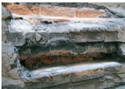
Rys. 2. Obraz zniszczonej wymurówki ceramicznej w kominach przemysłowych
