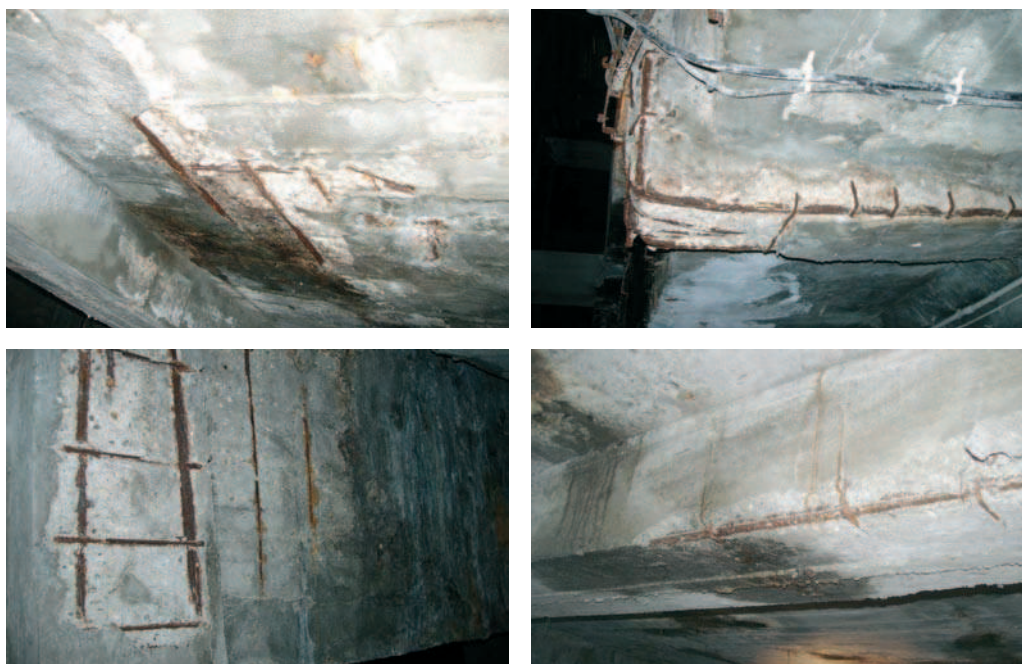
Rys. 2. Obrazy korozyjnych zniszczeń żelbetowej konstrukcji niecki
