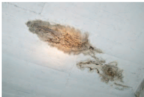
Rys. 4. Wycieki produktów korozji zbrojenia przez zarysowania dna niecki Fig. 4. Effluent of the reinforcement corrosion products across the cracks of swimming pool bottom
