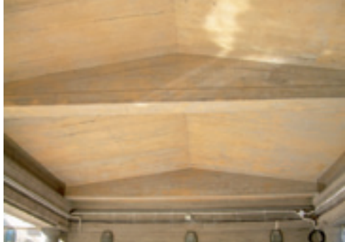
Fot. 3. Oryginalne powłoki malarskie
