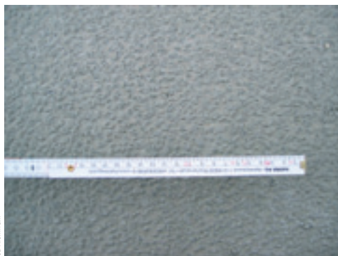
Rys. 4. Widok nawierzchni z odstąpionym kruszywem
