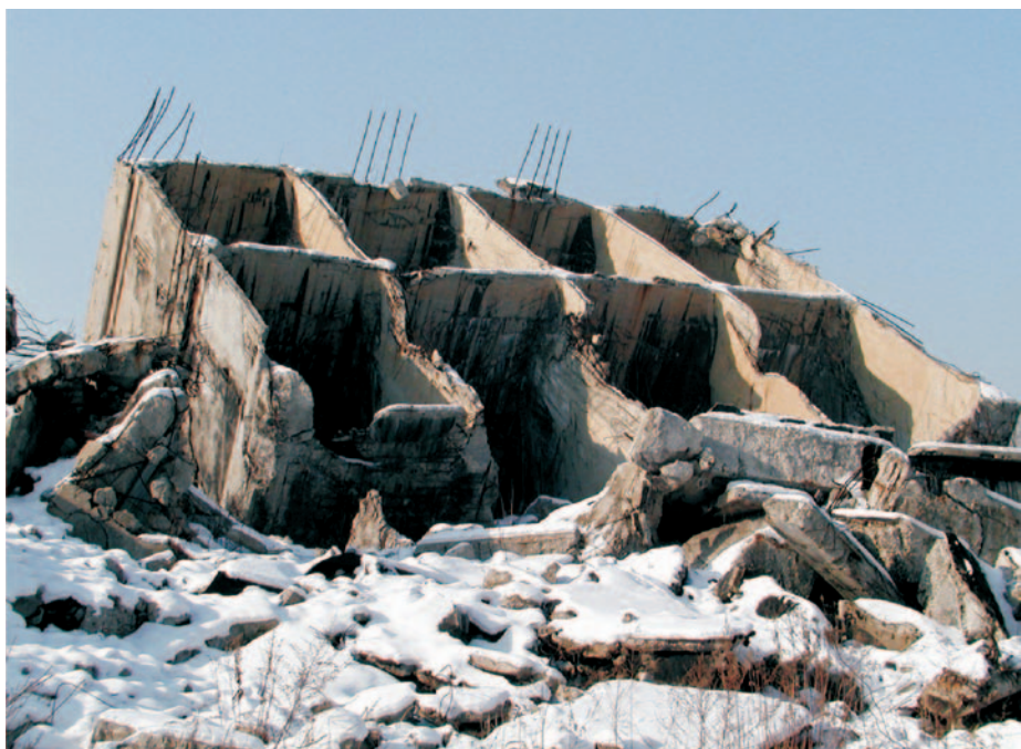
Fot. 2. Rozbiórka utrudniająca utylizację jest niezgodna z prawem
