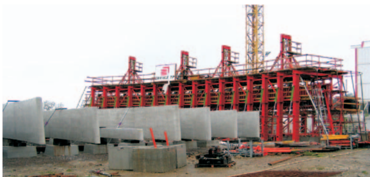
Fot. 8. Przyobiektowa produkcja elementów nowoczesnej konstrukcji ochronnej: prefabrykaty dwukrzywiznowej powłoki zadaszania wjazdu na odcinek autostrady, z ultrawysokowartościowego włóknobetonu (165 MPa), przystosowane do sprężenia (Francja, 2004)
