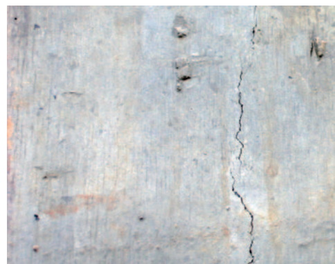
Fot. 4. Pęknięcie ściany zbiornika wskutek skurczu twardnienia
