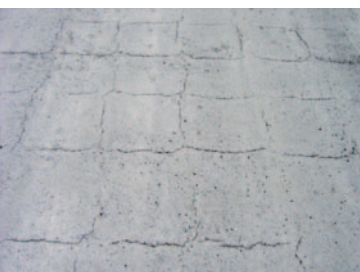
Fot. 2. Zarysowania płyty mostowej wskutek skurczu plastycznego
