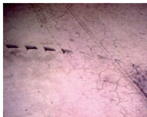
Fot. 1. Zarysowania wierzchniej warstwy posadzki przemysłowej
