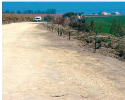
Fot. 1. Podbudowa pod drogę Ujazd – Zimna Wódka. Widoczne są także linki prowadzące dla układarki betonu Gomaco
