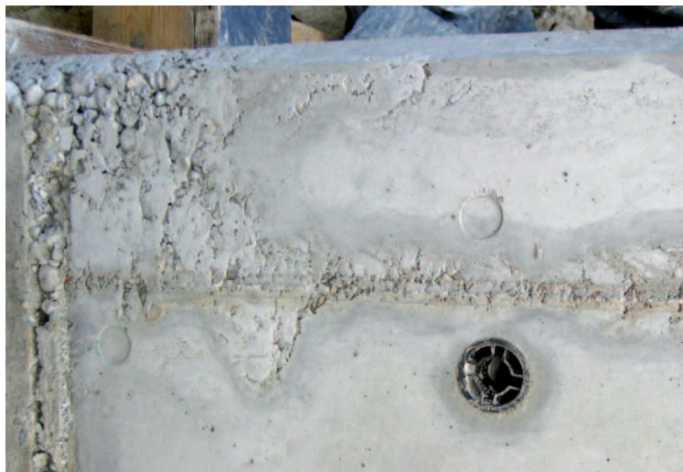
Fot. 7. Tak zwane gniazda żwirowe powstałe w wyniku nieuszczelnienia deskowania
