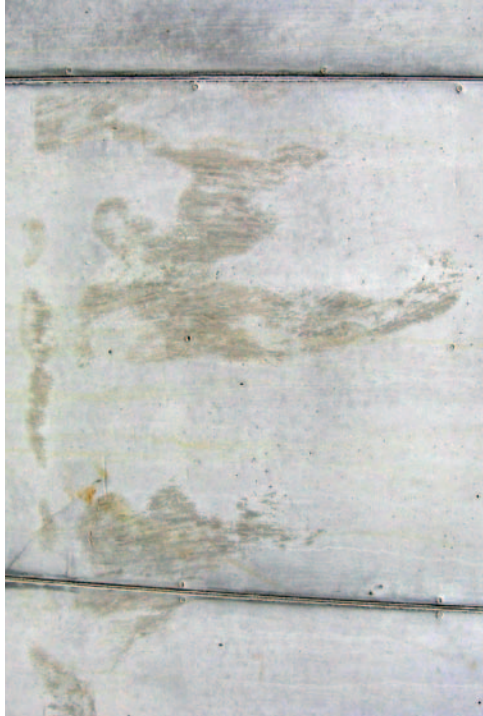
Fot. 13. Plamy powstałe wskutek zaschnięcia mleczka cementowego na powierzchni deskowania
