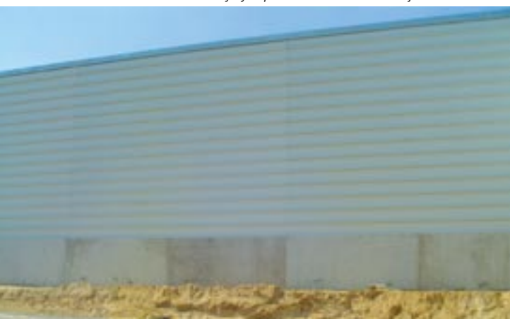
Widoczne różnice w kolorystyce powierzchni ścian elewacji hali
