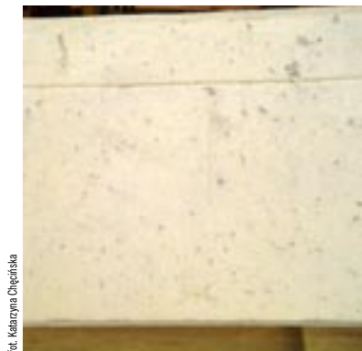
Wpływ procesów technologicznych na jakość powierzchni elementu prefabrykowanego: powierzchnia wadliwie wykonana
