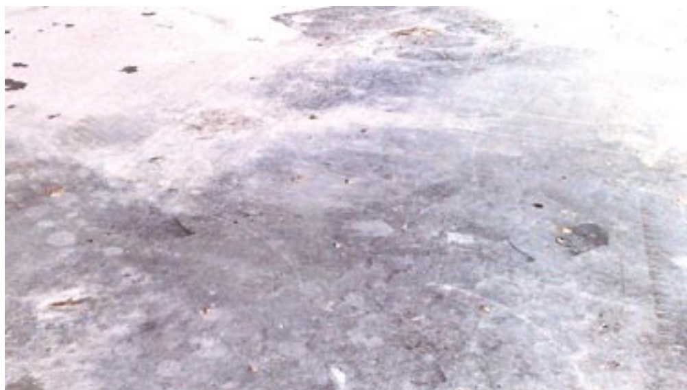
Rys. 3. Uszkodzenia powierzchni posadzki z charakterystycznymi „kraterami” po nietrwałym kruszywie po jednym sezonie zimowym. Ciekawostka – powierzchnia parkingu zaprojektowana i wykonana w technice DST
