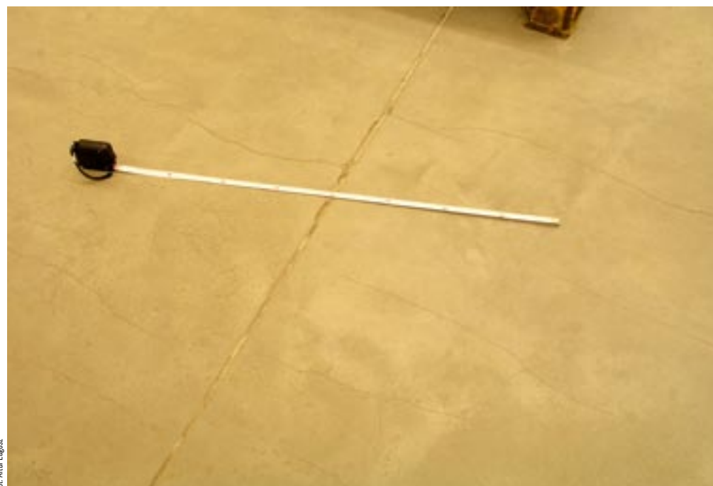
Rys. 1. Pęknięcia posadzki wywołane skurczem w związku ze wzrostem wskaźnika w/c – jako efektem wzrostu punktu piaskowego mieszanki kruszywo
