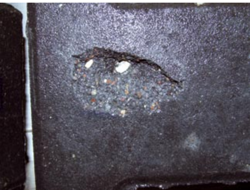
Fot. 4. Uszkodzenia kostki brukowej spowodowane pęcznieniem kruszywa grubego podczas cyklicznego zamrażania i rozmrażania. Odprysk na warstwie licowej w postaci charakterystycznego „lejka” z kruszywem pęczniącym – w tym wypadku marglem w środku
