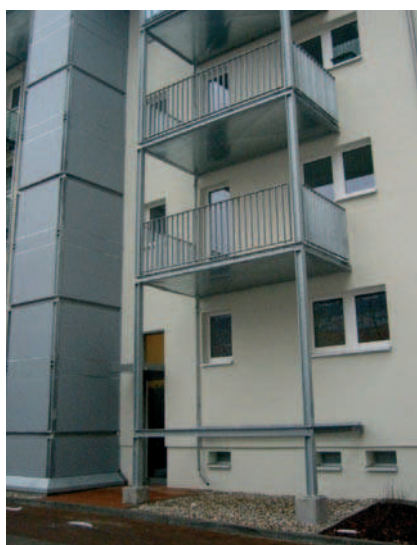
Fot. 5. Frankfurt nad Odrą, budynek po dostawieniu balkonów o konstrukcji stalowej (dwa słupy plus kotwienie do ścian) i wind do budynku, partery bez balkonów
