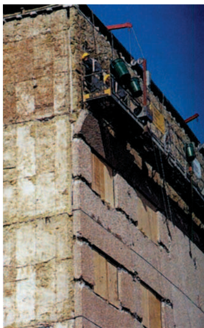
Fot. 16. Finlandia: widok elewacji w trakcie demontażu warstwy fakturowej w budynku wielkopłytyowym
