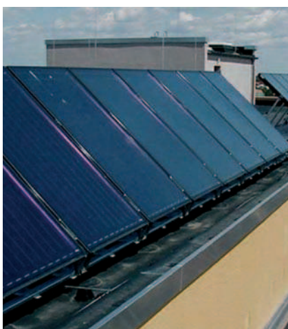
Fot. 11. Poczdam: Zeppelinstraße 164-172, alternatywne źródło podgrzewania ciepłej wody w budynku wielkopłytyowym, solary na dachu
