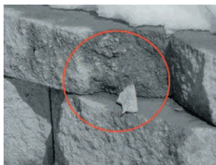
Rys. 9. Oderwane rozwarstwienie pęknięcia pod wpływem mrozu [4]
