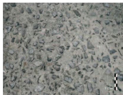
Rys. 11. Powierzchnia betonu po złuszczeniu [1]
