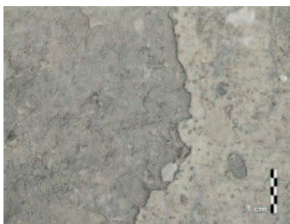
Rys. 10. Złuszczająca się powierzchnia betonu [1]
