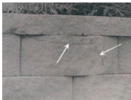
Rys. 6. Pęknięcia na czołowej części ściany z powodu propagacji mikro-pęknięć podczas zamarzania i odmarzania [4]
