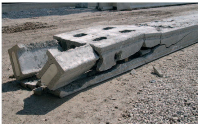
Rys. 9. Zniszczenie po upadku płyty – koniec B
