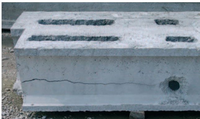
Rys. 7. Zarysowanie poziome ścianki – rozwarstwienie od otworu do końca płyty
