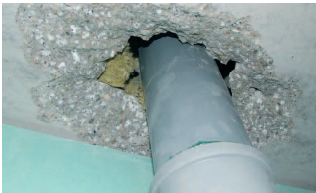
Rys. 12. Przykład wandalizmu wykonawców otworów na instalację w strunobetonowej płycie otworowej
