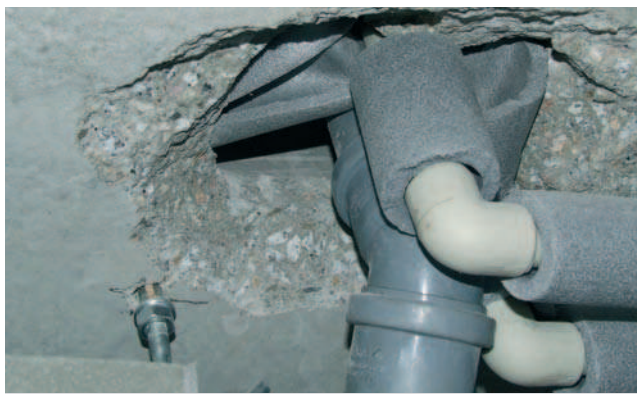
Rys. 13. Rozkucie dużego otworu, ze zniszczeniem otuliny splotów i znaczącym naruszeniem szerokości żeber, w celu upchnięcia kilku przewodów instalacji wodnej i kanalizacyjnej
