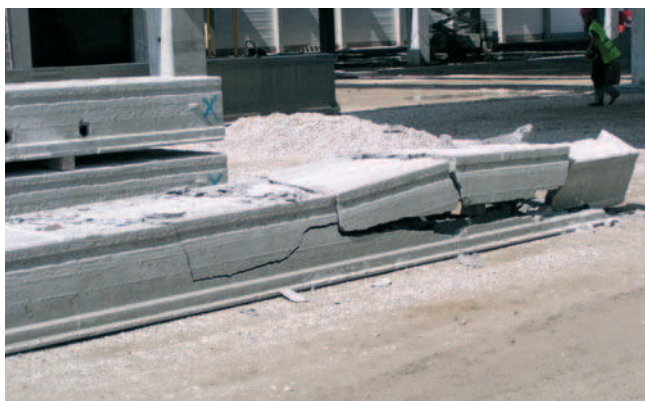
Rys. 8. Zniszczenie po upadku płyty – koniec A
