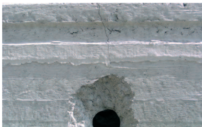
Rys. 6. Zarysowanie pionowe nad otworem, z silnym osłabieniem ścianki wokół otworów
