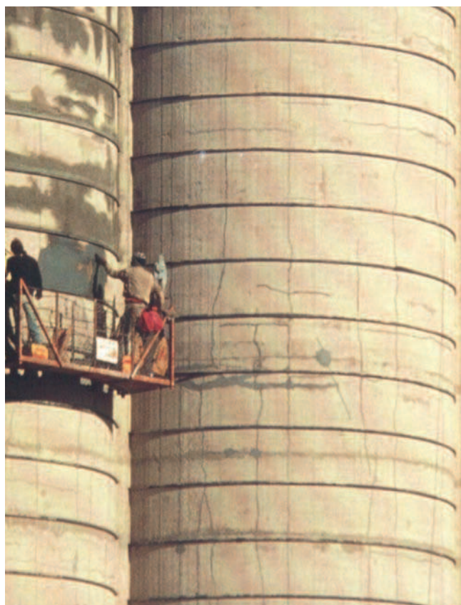
Fot. 1. Widok zarysowanej ściany żelbetowej w silosie cylindrycznym
