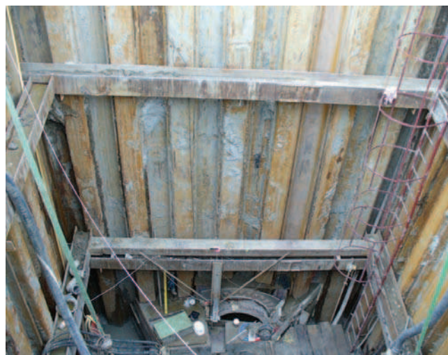
Rys. 5. Obudowa ścian wykopu początkowego wykonana z grodzic i kształtowników stalowych (zdjęcie własne)
