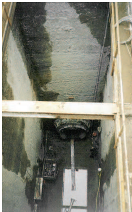
Rys. 8. Wykop początkowy o głębokości 16 m obudowany w technologii ścianki szczelinowej (zdjęcie własne)
