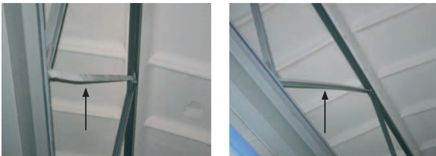
Rys. 6. Deformacje wyboczeniowe prętów wykratowania stężeń poprzecznych SP1 w nawie A – D
