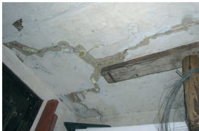
Rys. 7. Spękany strop odcinkowy w piwnicy, podparty stemplami zabezpieczającymi przed jego zawaleniem
