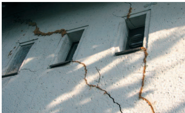
Rys. 6. Spękana w obszarze trzech okien kuchennych; zachodnia ściana zabezpieczona pianką przed przedmuchiwaniem
