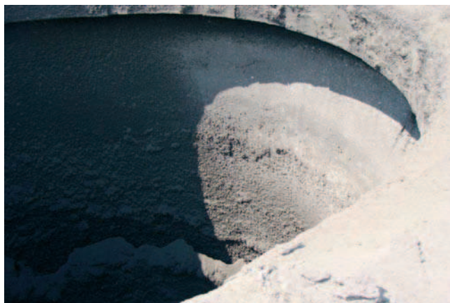
Rys. 1. Obsunięcie się przewodu żarobetonowego względem trzonu żelbetonowego o 3 m, w wyniku lokalnej utraty stateczności powłoki przewodu
