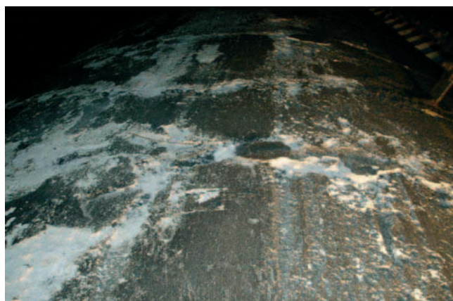
Rys. 6. Uszkodzenia korozyjne żarobetonu na zewnętrznej powierzchni przewodu
