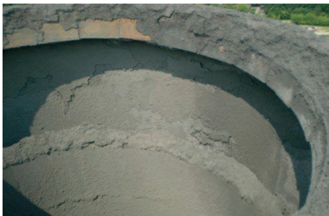
Rys. 3. Obniżenie się przewodu żaroodpornego względem trzonu o około 1,3 m w wyniku utraty stateczności miejscowej płaszczu
