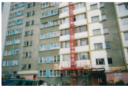
Rys. 7. System wielkopłyty, ocieplenie wykonano bez oceny stanu technicznego, I ETAP – ściany szczytowe i filarki – metoda lekka-sucha, stan w 2000 r. [11]
