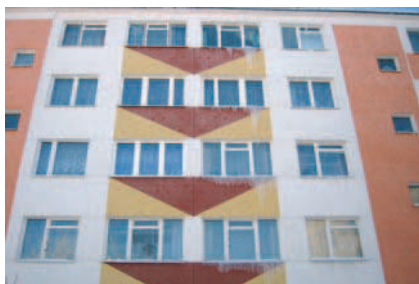
Rys. 10. Budynek systemu wielkopłyty przy ul. Skołuby 5, budynek po II etapie ocieplenia. Różnorodna stolarka okienna, przemarzanie ocieplonych ścian, widoczne sople i mostki punktowe w miejscach montowanych kołków; narożnik elewacji po II etapie ocieplenia, stan luty 2002 r. [11]
