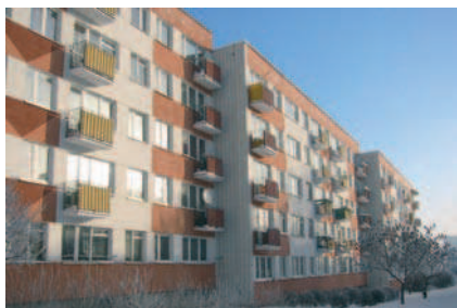
Rys. 9. Budynek systemu wielkopłyty przy ul. Skołuby 5, elewacja po drugim etapie ocieplenia. Zachowano detal podziału elewacji na filarki międzyokienne i belko-ściany, ale skrócono długość okapników zewnętrznych, stan luty 2002 r. [11]
