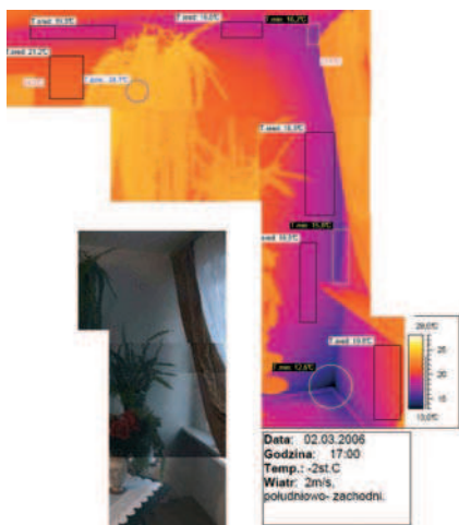
Rys. 13. Termogram, parter ściana półszczytowa narożnik południowo-wschodni, budynek wielkopłytkowy przy ul. Prążniczki 5/51 [11]
