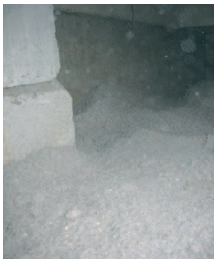
Rys. 12. Aktualne ocieplenie stropodachu ekofibrem [11]
