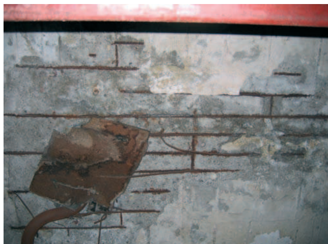
Rys. 1. Powierzchniowy ubytek otuliny w płycie, widoczne skorodowane pręty, zubożony beton
