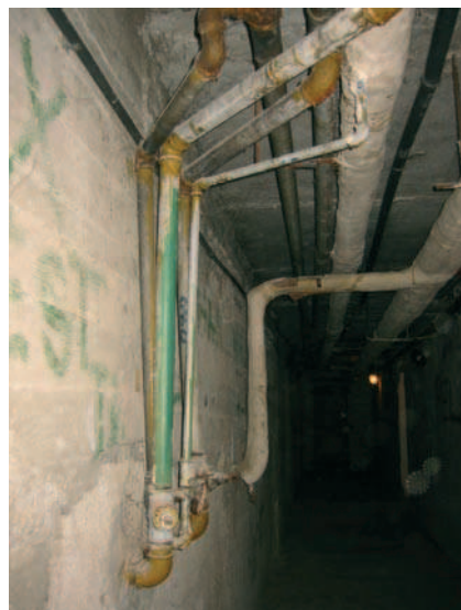
Rys. 16. WBLŻ – piwnice, stan instalacji c.w.u. i c.o. [13]
