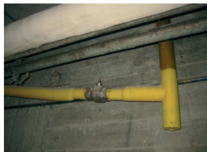
Rys. 15. WBLŻ – piwnice, stan instalacji gazowej [13]
