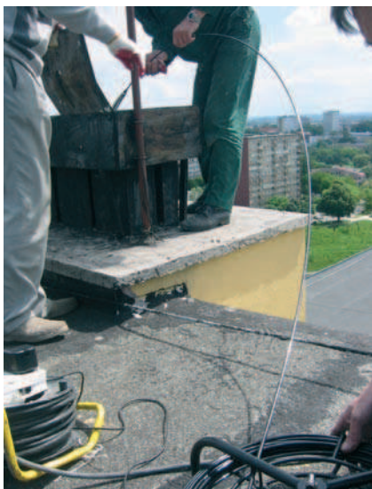
Rys. 13. Badanie drożności wentylacji XI kondygnacji budynku wieloblokowego [13]
