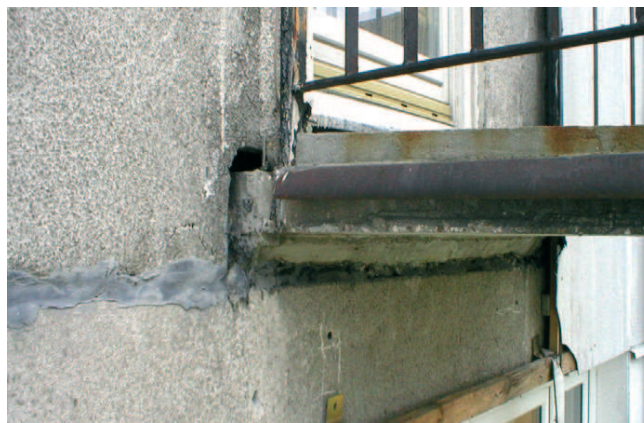
Rys. 8. Widok balkonu wspornikowego podczas demontażu ocieplenia. Brak uszczelnienia na styku ściana – balkon, zbyt krótka obróbka blacharska, zły stan barierki [13]
