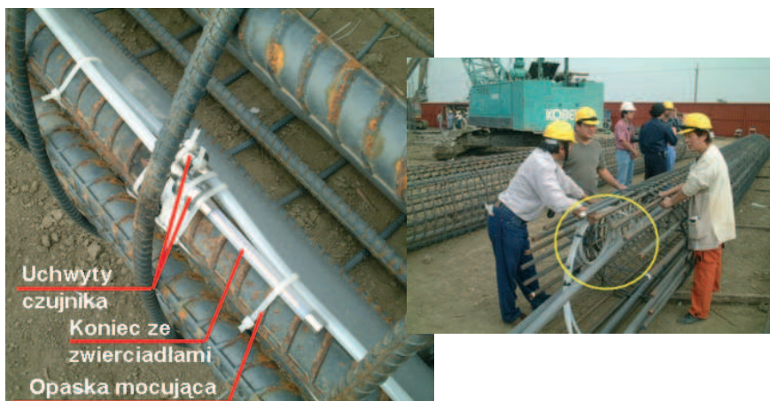
Rys. 19. Sposób mocowania czujników światłowodowych do zbrojenia przyszłych pali żelbetowych (dzięki uprzejmości SMARTEC SA, Manno, Szwajcaria)
