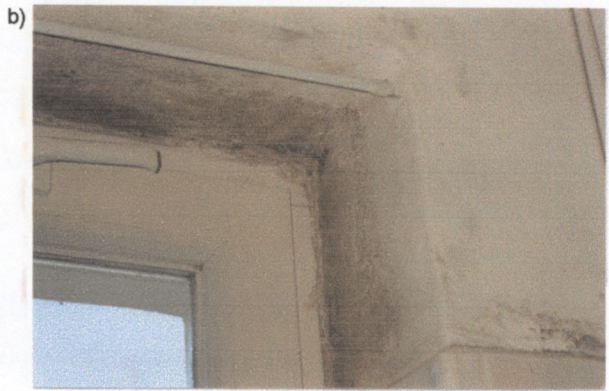
Rys. 9. Budynek mieszkalny w Ostrowi Mazowieckiej: a) fragment elewacji, b) pleśń wokół okna Fig. 9. Dwelling house in Ostrów Mazowiecka: a) part of faade, b) moulds around window
