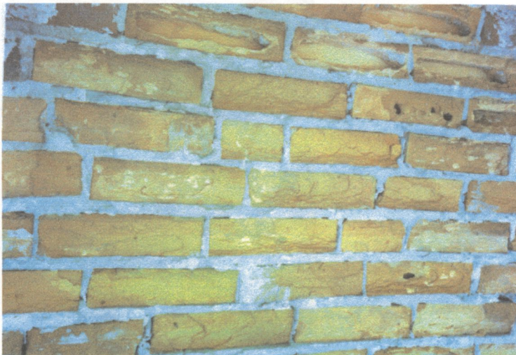
Rys. 11. Uszkodzenie muru wskutek nagrzewania Fig. 11. Masonry failure due to solar operation
