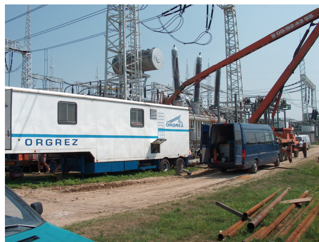
Fot. 1. Stacja regeneracji oleju transformatorowego na stanowisku pracy Photo 1. Station of transformer oil regeneration at the workplace
