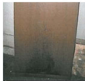
Fot. 12. Widoczne na przegrodzie międzyfazowej ślady wyładowań
