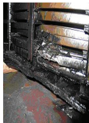
Fot. 11. Wypalenie na fazie L2 w dolnej części uzwojenia GN przy zacisku liniowym,
