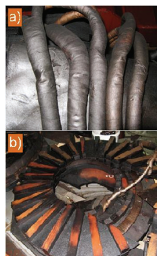
Rys. 1. Wnętrze transformatora z osadami na: izolacji nawojowej (a), elementach konstrukcyjnych kanału olejowego (b)
