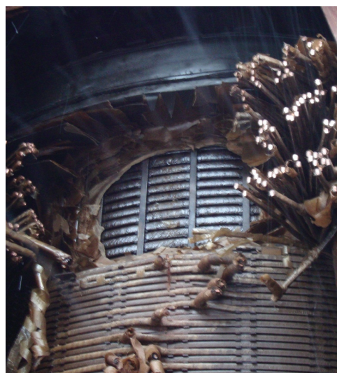
Rys. 3. Wycięty fragment uzwojenia regulacyjnego i widoczne uzwojenie górnego napięcia (szeregowo)
